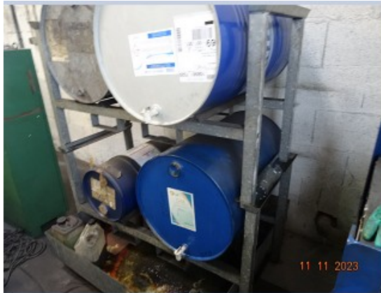
Volume de rétention non conforme
