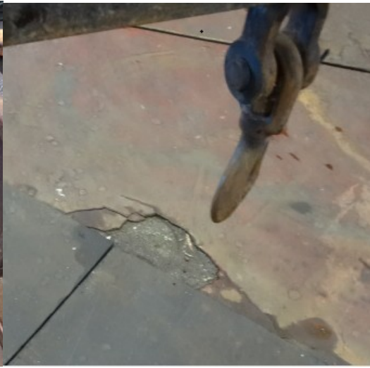
Défaut résine d'étanchéité
