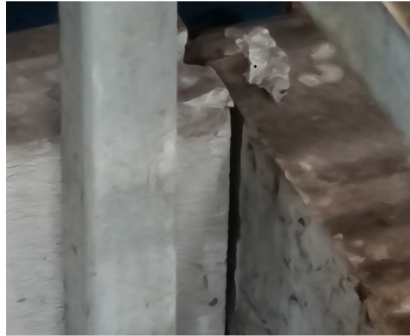
Fissure de la rétention
